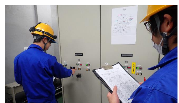
～設備社員：変電所直流遮断器事故復旧訓練～
