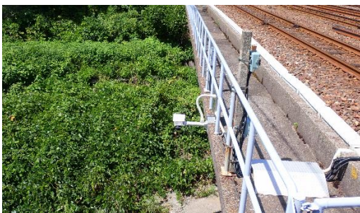
～名立川水位計新設～
