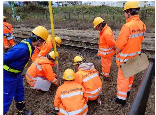
〈消雪設備の点検〉
