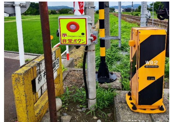
〈踏切支障報知装置〉
